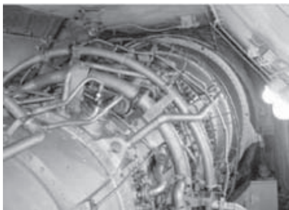
Рис. 2. Газотурбинный двигатель внутри укрывающего кожуха
