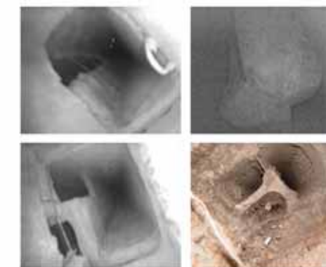
Рис. 2. Образцы типичного строительного брака в каналах вентиляционных шахт зданий
